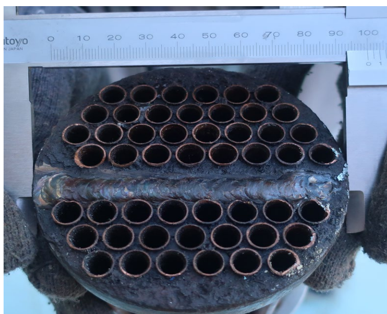
Рис. 6А. Диаметр фланца со стороны конечного изгиба потока для трубного пучка масляного охладителя E-3414: d = 100\text{ mm} . (Задняя сторона теплообменника).
