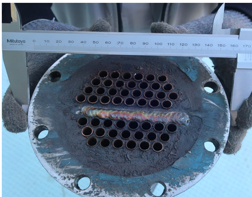
Рис. 6. Диаметр фланцев вход и выход сторона для трубного пучка охладителя масла E-3414. d=170\text{mm} . (Передняя сторона теплообменника).
